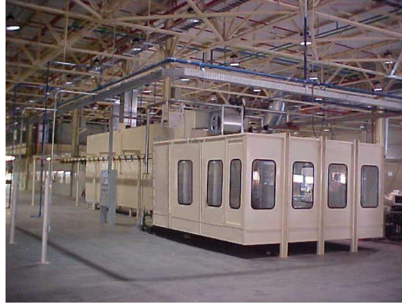
Instalação com Estufa Contínua na Ford-Camaçari
